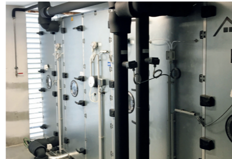
Die hocheffiziente Energierückgewinnung, die auf Basis eines Kreislaufverbundsystems in die bestehende Lüftungszentrale integriert wurde, sorgt für höchste Einsparungen.
