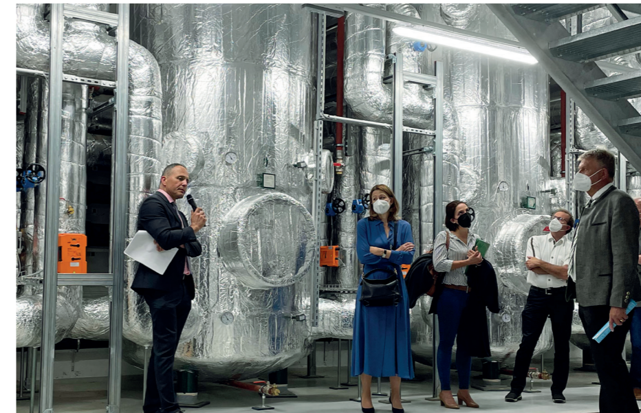
Bei der Begehung und offiziellen Eröffnung der Energiezentrale gab es viel Lob für die umgesetzten Energieeinsparungen des BKH Schwaz.
