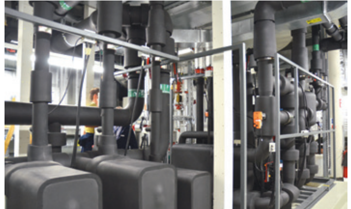
Die hydraulische Baugruppe des HKVS von Konvekta. Drei Umformer für das Kaltwasser und ein grosser für das Heizwasser konditionieren die Lüftungsgeräte. Imposante Größe in der Mitte der Zentrale
