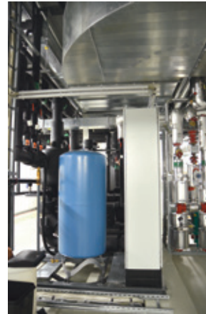
Seitenansicht der hydraulischen Baugruppe mit dem WRG-Controller und dem Ausdehnungsgefäß
